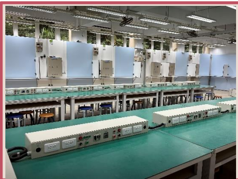
工業配線丙級檢定場
