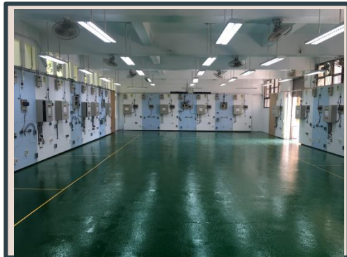
室內配線丙級檢定場
